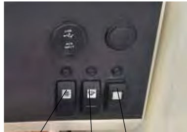
Strömbrytare Säkring 12 volts uttag
