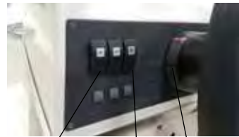
Strömbrytare Säkring 12 volts uttag
